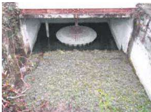
Chambre d'eau et ancienne turbine Francis
